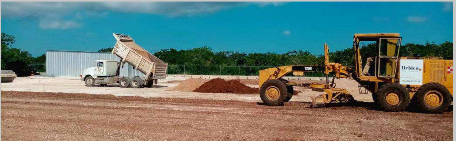
Maquinaria de Urbica realizando trabajos en el patio de maniobras de PetroServicios MegaCar. Carr. Mérida-Progreso
